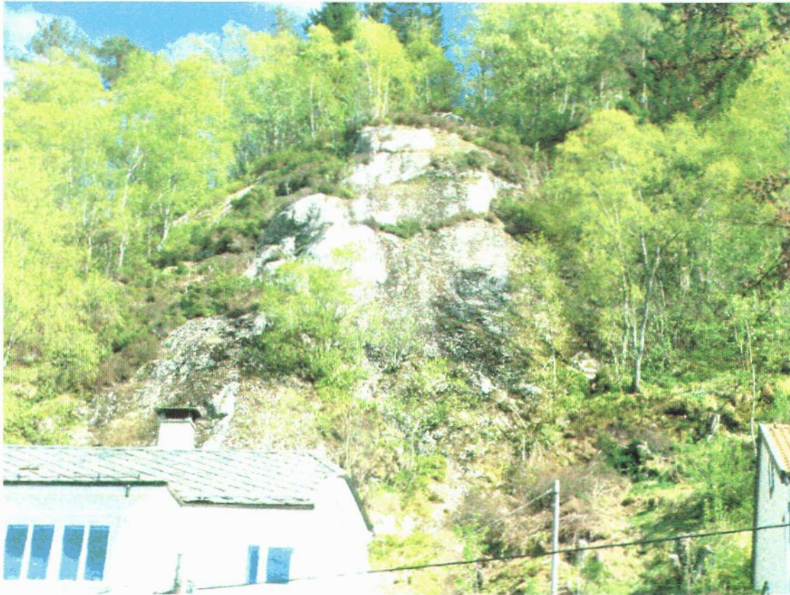
Bilde 5: Skråningen øst for nummer 21. Skråningen består her i hovedsak av bart fjell. Fjellet er noe oppsprukket.
