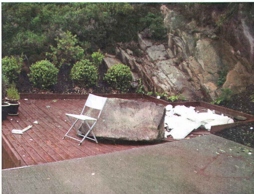
Bilde 1: Viser blokk fra steinspranget som traff terrasse ved garasje like ved bolig.
