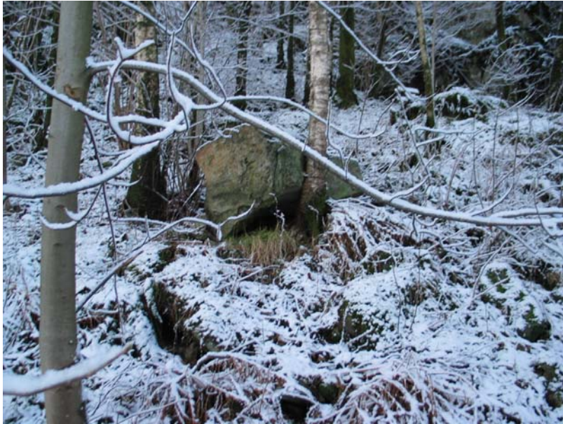
Figur 8 Steinsprangblokk under mindre framspring med løst fjell i dalsiden over Nedre Smøråsvei 30-44.
