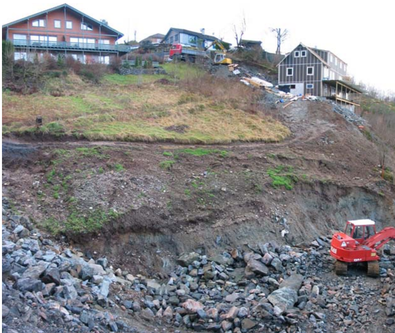
Figur 6 Foten av løsmasseskråning er kuttet ved Birkelandsbotn 21A/B og 23.
