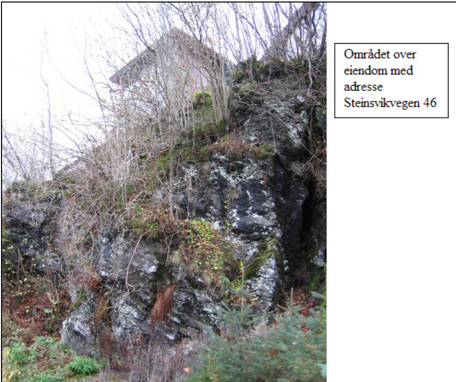
Figur 4. Bildet viser Bergskrent over Steinsvikvegen 46. I øvre del av bildet sees hus med adresse Markanaset 10 som nylig ble reist.
