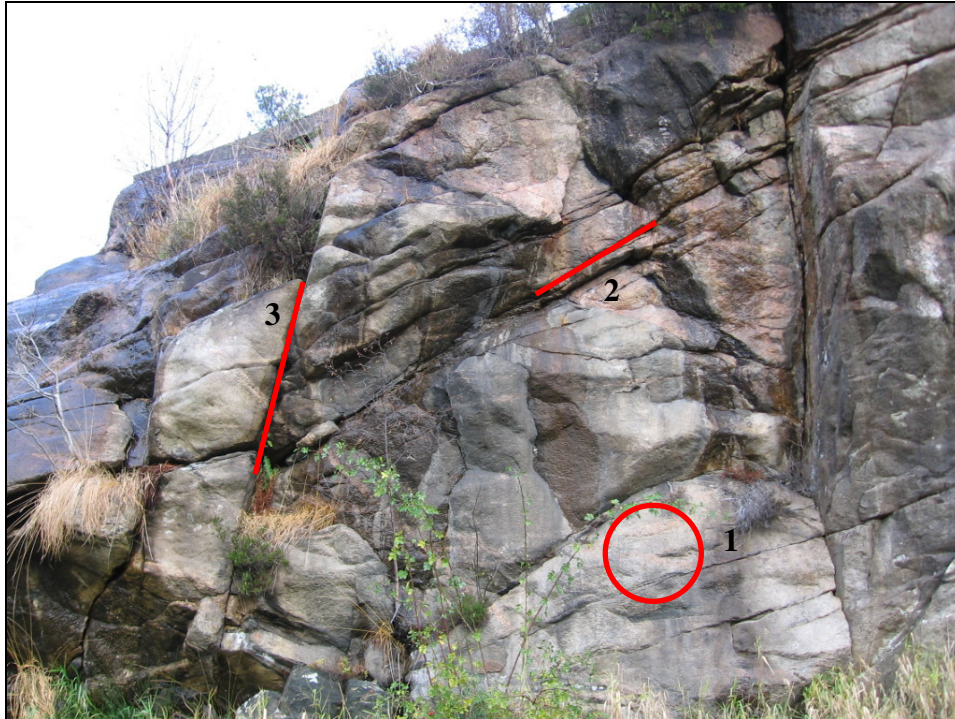
Figur 6 Oppriss av bergvegg med tre hovedsprekkesystem. Sirkel viser sprekkeflate til sprekkesystem 1, som er sammenfallende med bergartens foliasjon.
