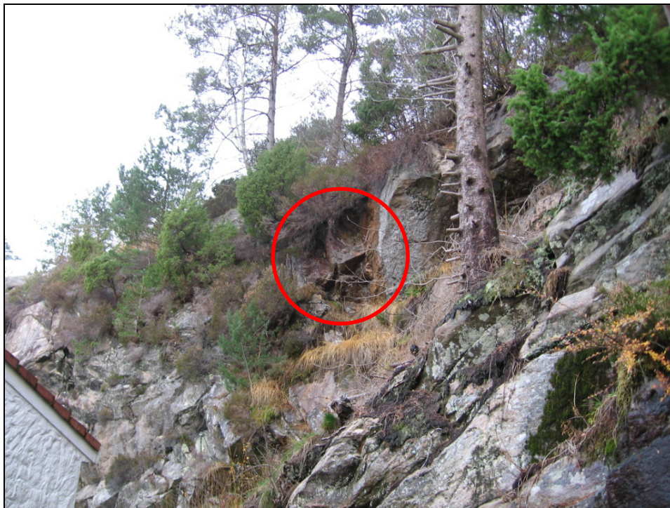
Figur 8 Sår i bergmasse etter nedfall av blokker og stein.
