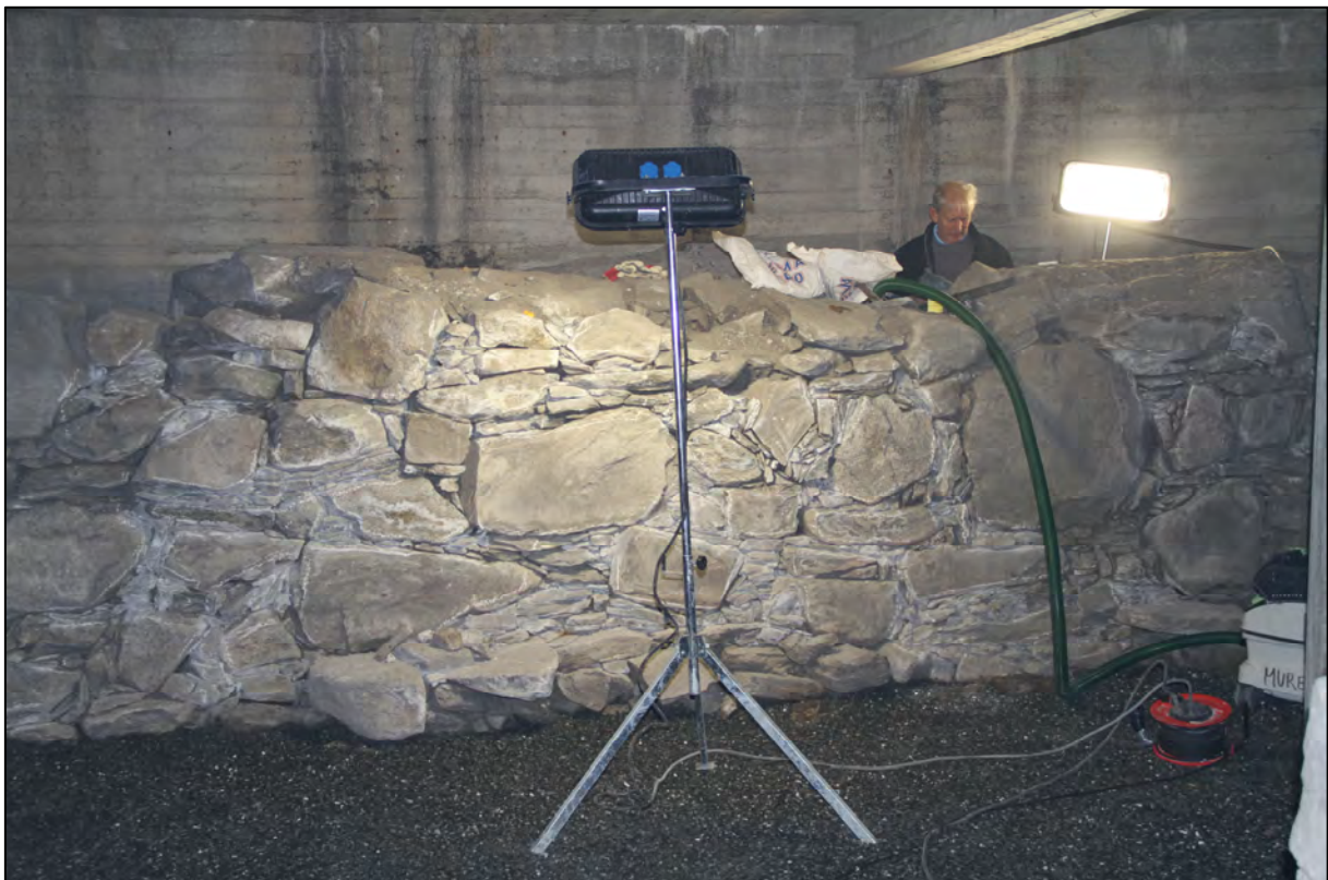
Figur 5: Deler av innerlivet til nordmuren, ferdig konservert. Det er stedvis utbredt bruk av pinningsstein. Arvid Grindheim limer sprukken stein i ytterlivet på nordmuren (Foto: Bergen kommune, Byantikvaren 2013).
