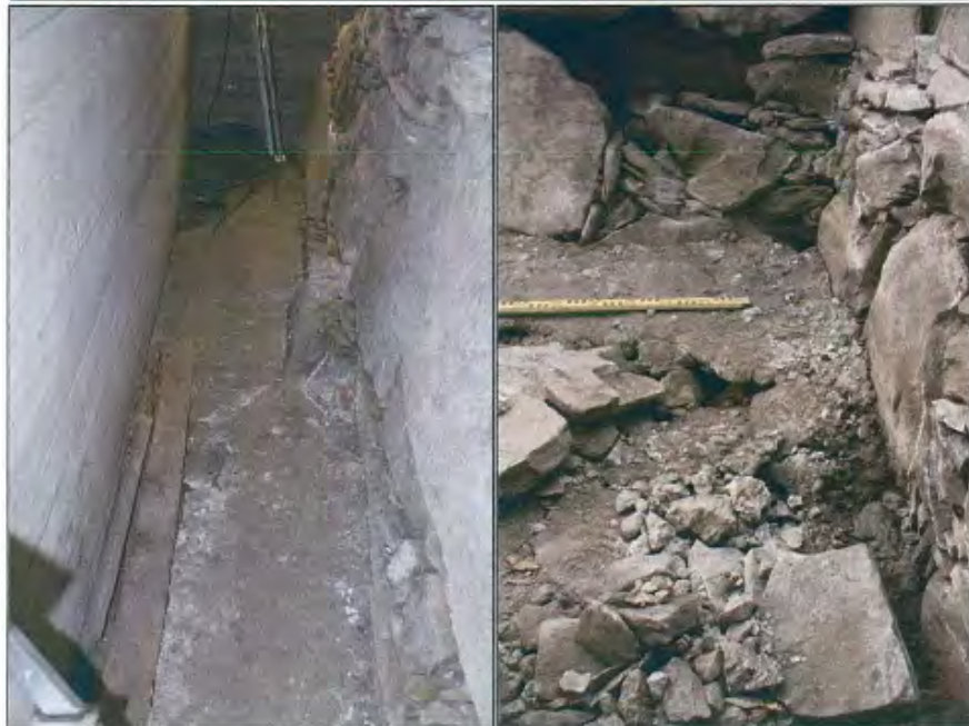
Over: Tilstanden til magerbetonggulvet inne i ruinrommet er dårlig. Stedvis går gulvet i oppløsning (Foto: Byantikvaren i Bergen 2013). Venstre: Eksempel på oppsprekking av gulvet sør for ruinen (Foto: Byantikvaren i Bergen 2013). Høyre: Langs vestmuren inne i ruinrommet går gulvet fullstendig i oppløsning, og steinene som er lagt mellom søylefundamentene og magerbetongen kommer til syne (Foto: Byantikvaren i Bergen 2013).
