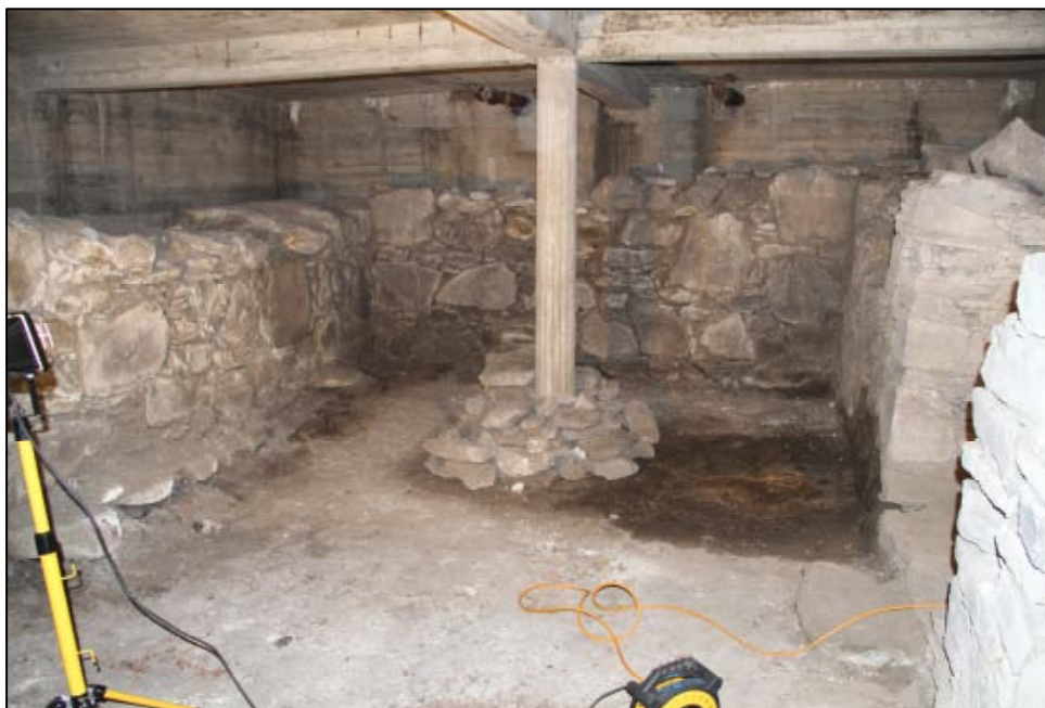
Illustrasjon 30: Oversiktsbilde av ruinen og rommet den står i, mot øst. Det fuktige området på gulvet kommer fra en lekkasje i taket (illustrasjon 31). Steinen som ligger rundt søyla ble stabet opp i østlig vindu etter utgravningen i 1935 (Foto: Byantikvaren 2011)
