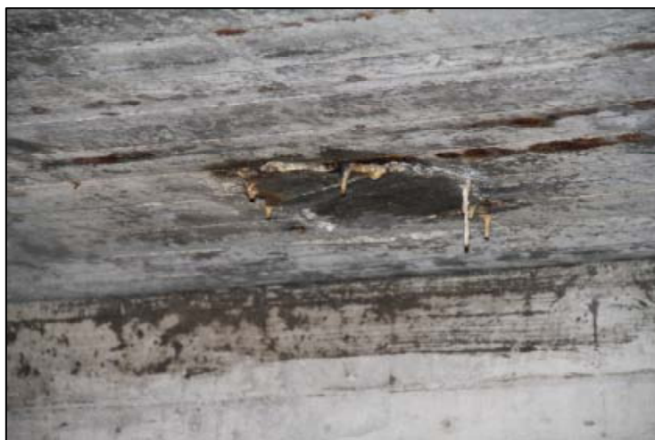
Illustrasjon 31: Lekkasje fra taket som fører til vått gulv i ruinrommet og at murverket absorberer fuktighet (Foto: Byantikvaren 2011)
