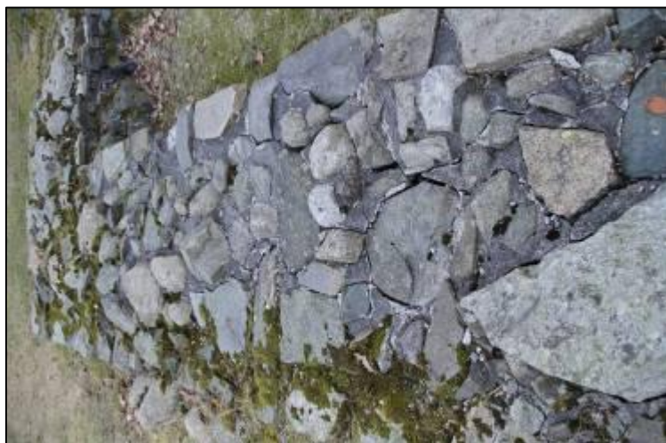
Figur 13: Foto av murkronen på S2. Betongen er sprukket opp og trekker vann (Foto: Byantikvaren 2011, mot SØ)
