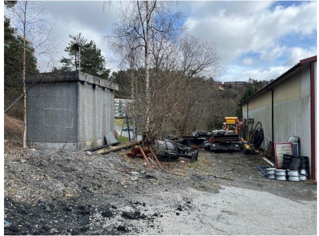
Figur 36 - Transformatorstasjon og bekke drag.
