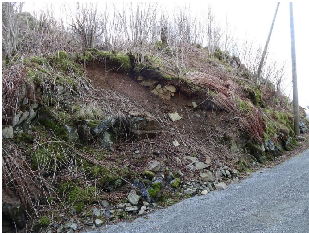
Figur 11. Mindre utglidninger av stein og jord i vegskjæring.
