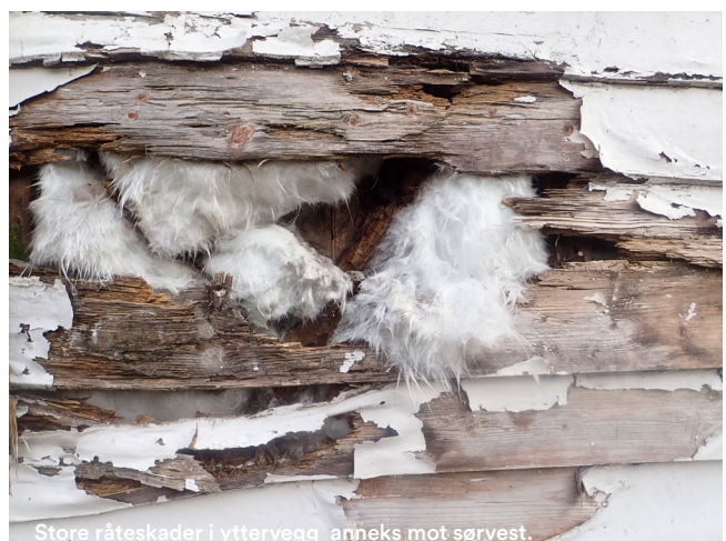
Store råteskader i yttervegg anneks mot sørvest.
