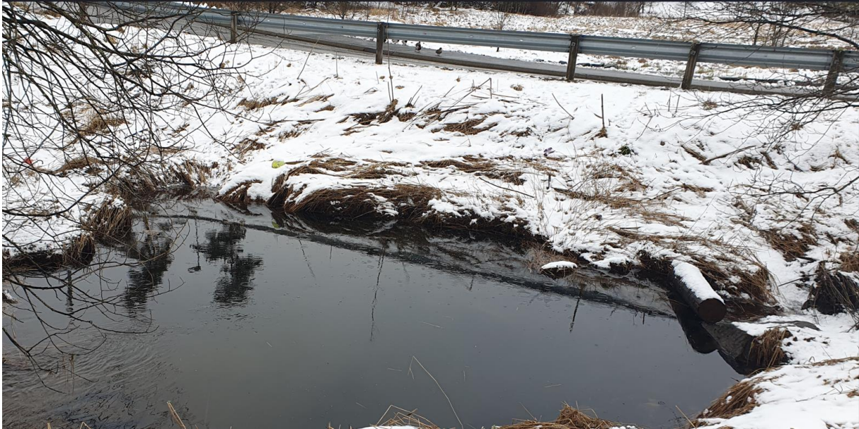
Figur 7: Sandalsringen / Nye Sædalsveien, neddykket rør leder normalt vann igjennom veien til våtmarksområdet nedstrøms og Sanddalselva. Dimensjon rør er vurdert til 80-100 cm. Ved større vannføring vil elva krysse over veien.
