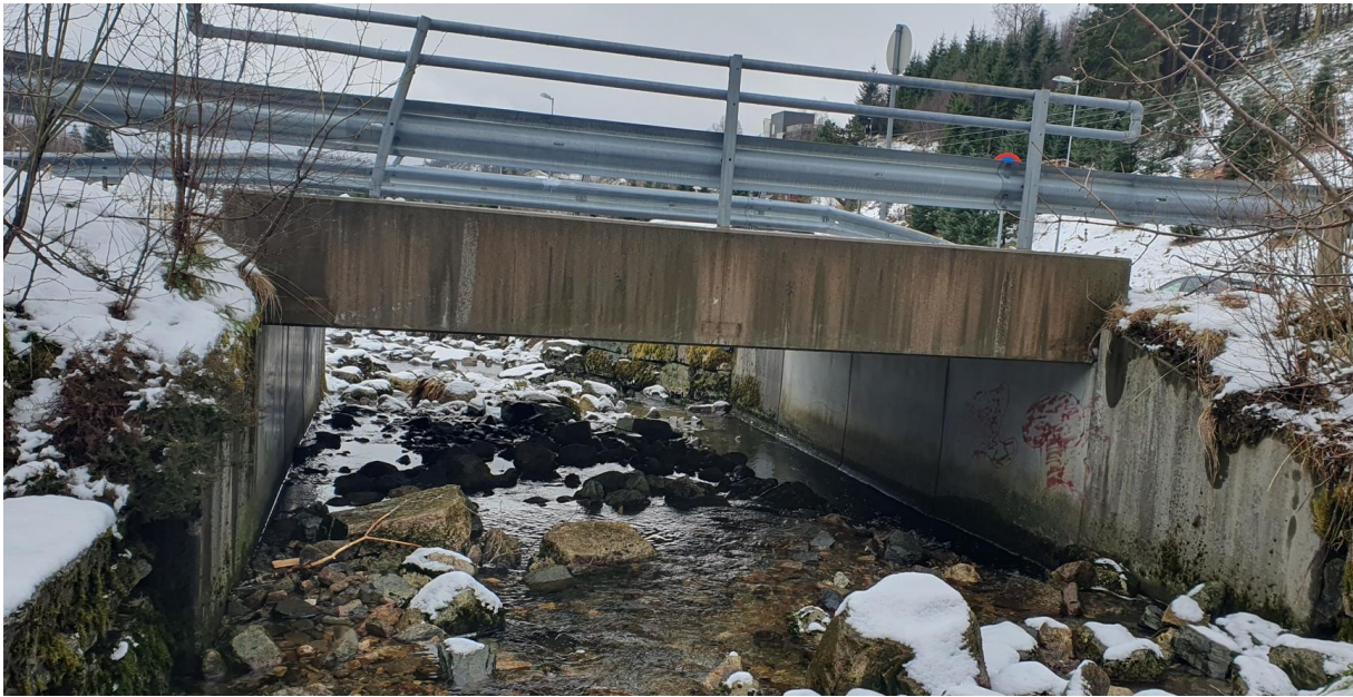
Figur 5: Bru 3 har lysåpning på 5 x 1,4 m. Landkar i betong. Flomvei vurdert som diffus (vanskelig å fastslå ved øyemål).
