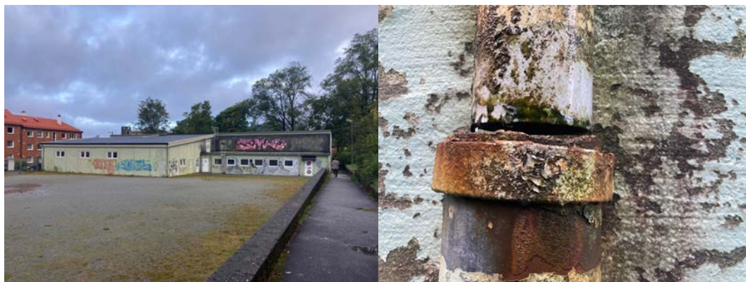
Figur 8 Fra befaring 23.09.2022, bygget sett fra grusbanen (t.v.), og nedløpsrør på byggets bakside (t.h.) Ola Roald AS Arkitektur
