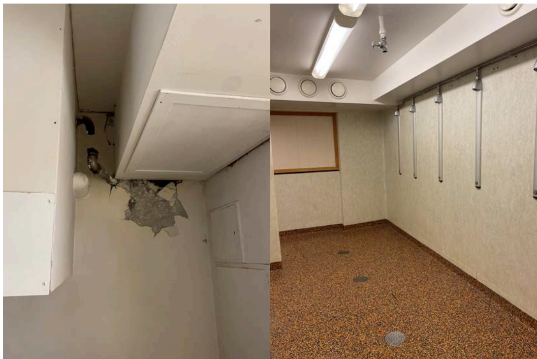
Figur 11 Bilder tilsendt fra Rektor ved Langhaugen 8. november 2022 som viser dusj og gang i garderobeanlegget, viser sprekke i rør, skader på vegg.
