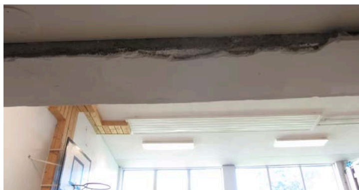
Figur 10 Muggsopp-funn i gymbygget oktober 2017. Foto: Bergens Tidende
