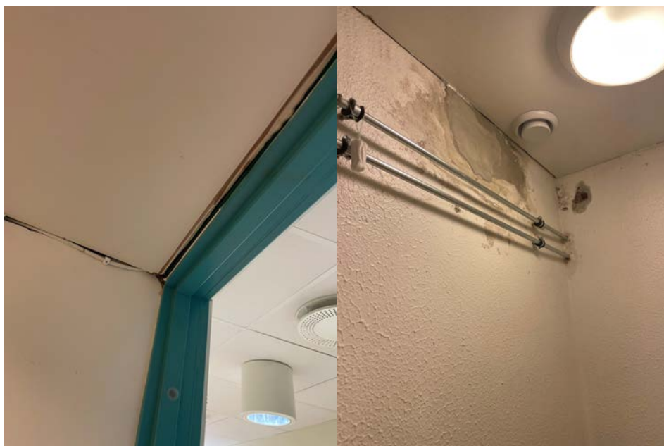
Figur 12 Bilder tilsendt fra Rektor ved Langhaugen 8. november 2022 tatt inne i gymbygget viser mangelfull tetting rund dør og reparasjoner i vegg.
