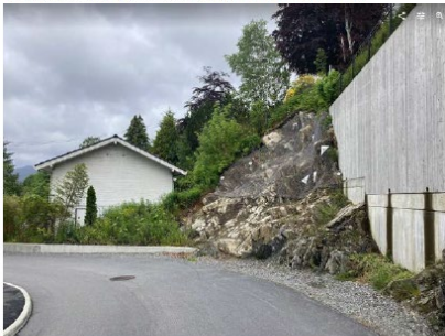
Figure 12 Bildet viser skredren som er mellom Skjoldstølen 40B og planlagt utbygging. Tilsvarende støttemur må forlenges i grenselinjen, med støvskjerm på toppen
