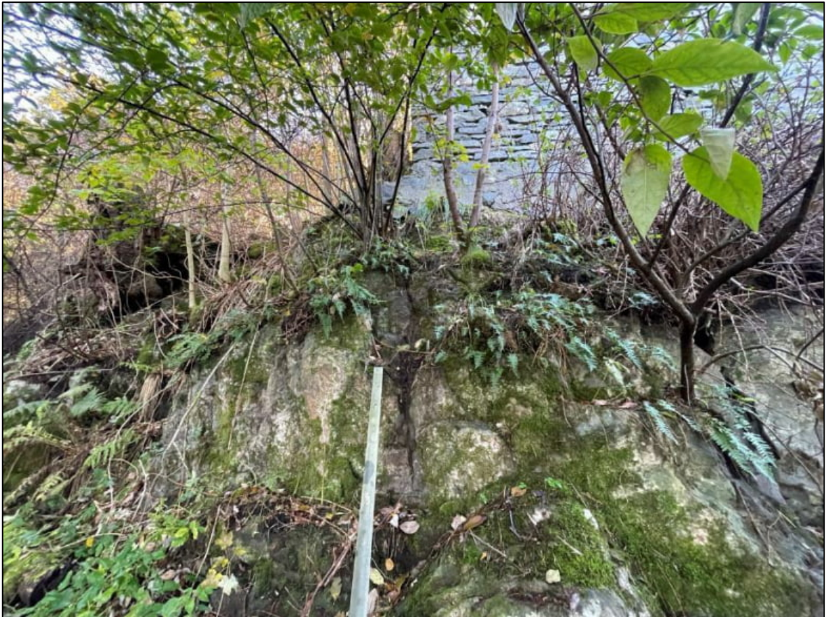
Figur 8. Bergskrent i underkant av Sundts veg 5. Bergskrenten er opp mot 2 meter høy. Mur synlig i bakkant. Bildet er tatt mot øst.
