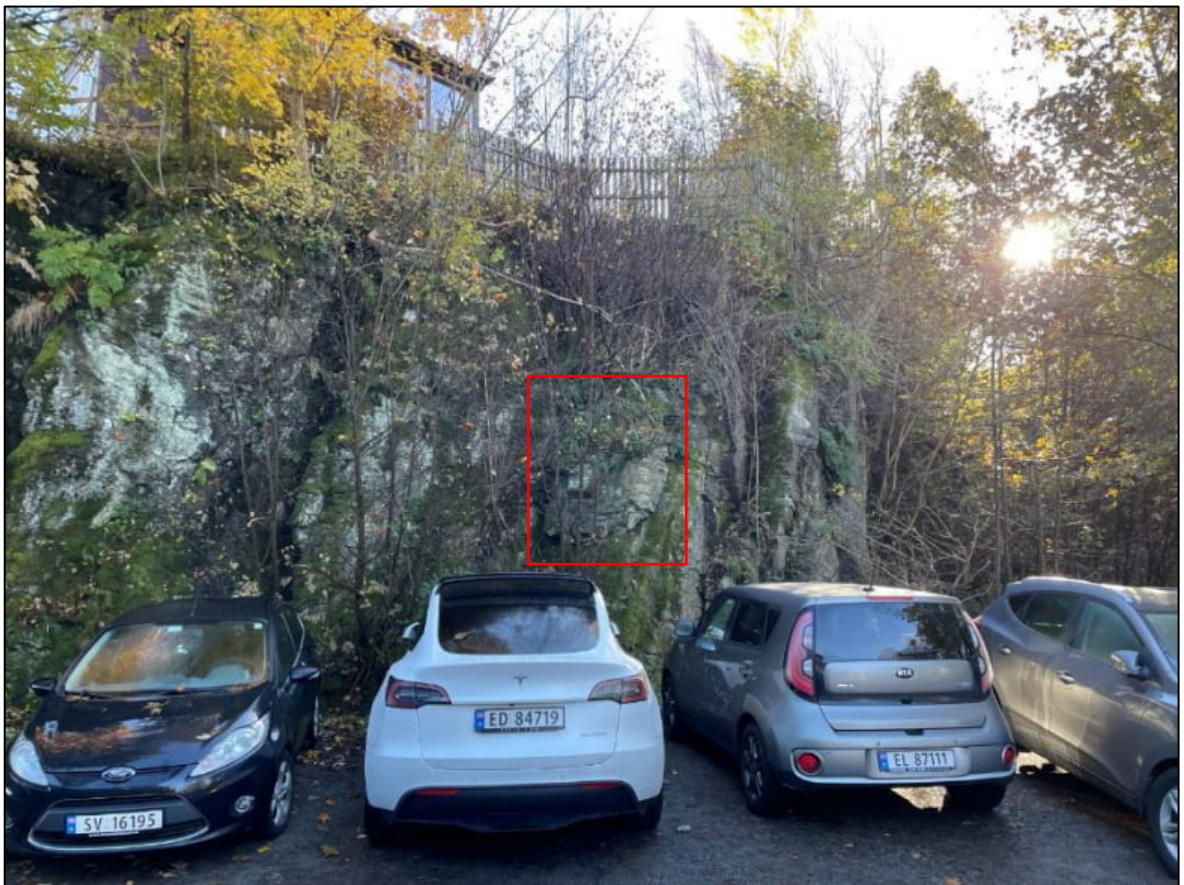
Figur 6. Bergskrenter i nordøstlig del av kartleggingsområdet. Skrentene er opp mot 9 meter høye og med lav mur i overkant. Bolig ved Nesttunvegen 101B synlig i overkant. Merk avgrenset blokk sentral i bildet (markert med rød firkant). Bildet tatt mot sør.
