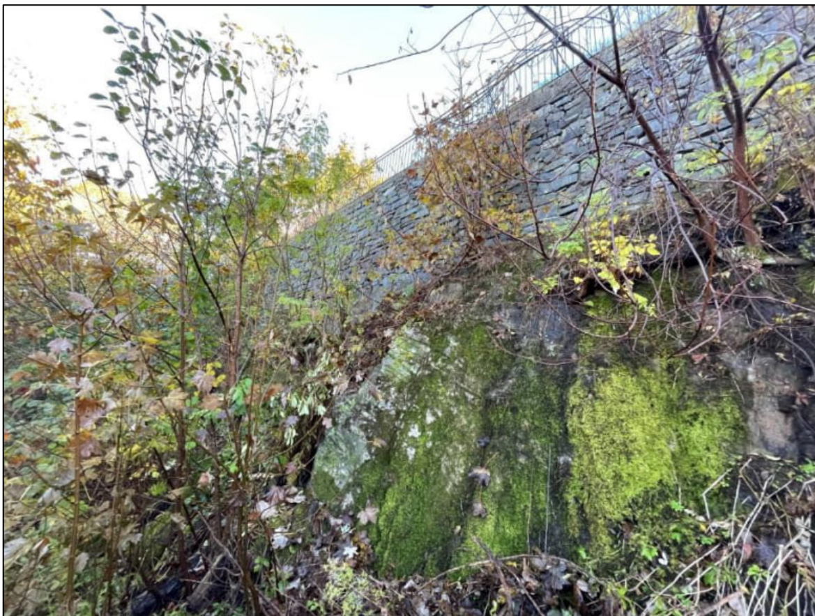
Figur 5. I underkant av Sundts veg 5 mot vest er det etablert natursteinsmur fundamentert på berg. Muren er støypt.
