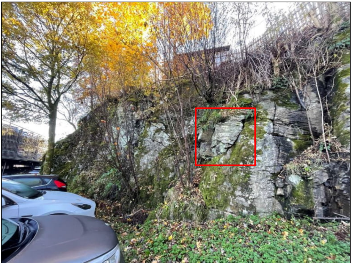
Figur 3. Bergskrent i nordvestlig del av kartleggingsområdet. I topp av skrent er det etablert en lav mur i underkant av Nesttunvegen 101B. Rød firkant indikerer avløst blokk med fare for steinsprang.
