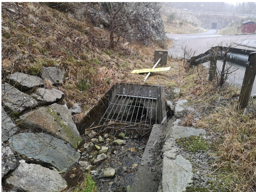
Figur 5 Bekkeinntak vest for ny planlagt bebyggelse (foto: Multiconsult)
