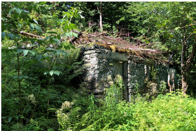
Figur 4-8 Ruin av uthus/fjøs ved Myravegen 17.
