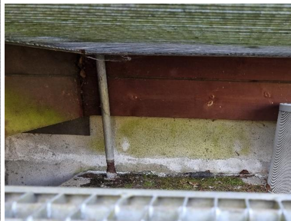
Bilde nr. 2.08 Langsgående horisontalt riss. Fortsettelse av riss som vises på bilde nr. 2.07.
