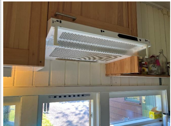
Bilde nr. 3.07 Avtrekk på kjøkkenet. Ventil på vindu.
