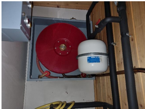
Bilde nr. 3.06 Brannslange.
