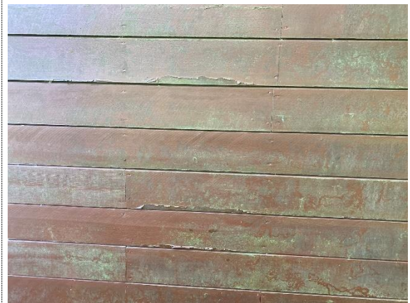
Bilde nr. 2.16 Kledning med begroing og avskallet maling.
