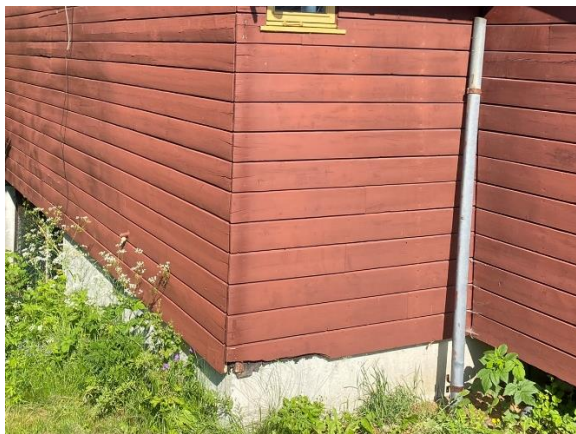
Bilde nr. 2.15 Noe av kledningen på nederste bord er knekt av, gjør det mulig å observere vindspærre i form av veggpapp.
