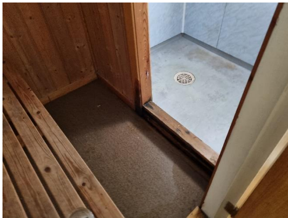
Bilde nr. 2.37 Banebelegg på dusjrom. Nede mot høyre i bildet kan man se vannoppsamling på gulvet.
