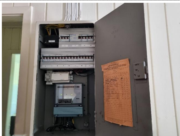
Bilde nr. 4.02 Automatsikringer i en leilighet i bygg 9.
