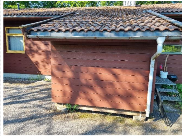
Bilde nr. 2.44 Motfall på takrenne.
