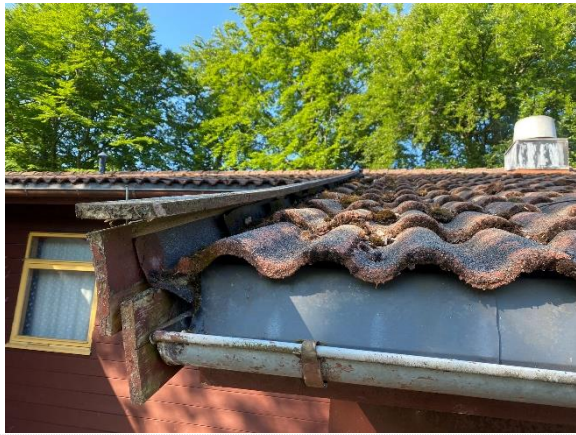
Bilde nr. 2.43 Avskallet maling og begroing på vannbord.
