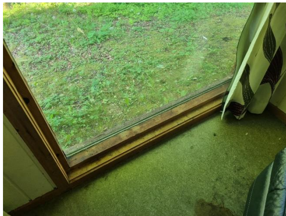
Bilde nr. 2.19 Misfarging fra fukt på vinduskarm på vindu fra byggeår.
