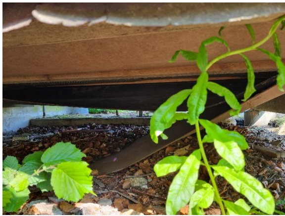
Bilde nr. 2.31 Trefiberplate som har løsnet.
