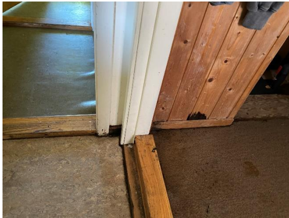
Bilde nr. 2.27 Innervegg av stående trepanel, beiset overflate. Vann har trukket opp i panelet.
