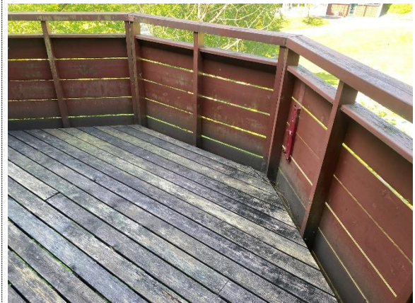
Bilde nr. 2.48 Begroing på terrassebord og rekkverk.
