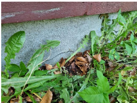
Bilde nr. 2.07 Sett fra nordøst. Horisontalt riss i ringmur.
