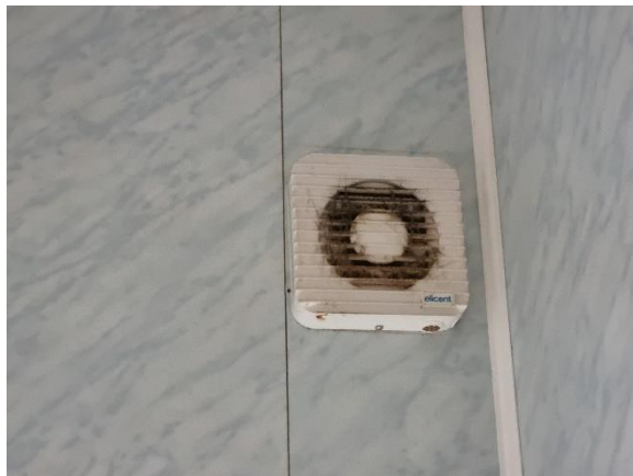
Bilde nr. 3.08 Avtrekk på dusjrom.
