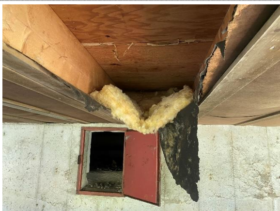
Bilde nr. 2.11 Bygg 8. Åpning gjør det mulig å observere isolasjon, vindspærre og undergulv.
