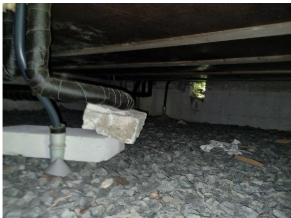
Bilde nr. 3.04 Vann og avløpsrør under bygg 8.
