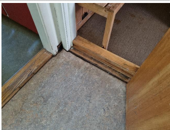
Bilde nr. 2.33 Gulvbelegg som buler og slipper overflaten.
