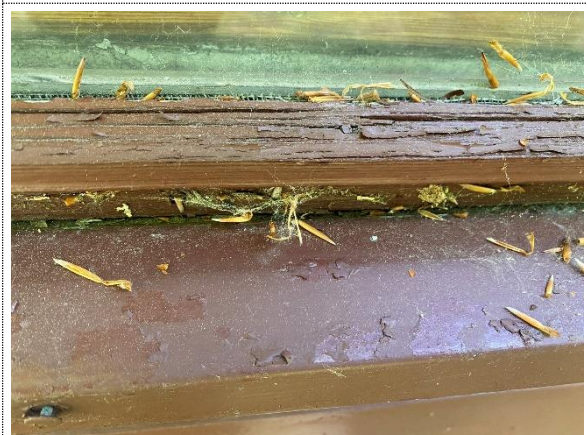
Bilde nr. 2.18 Oppsprukket trevirke ved vinduskarm på vindu fra byggeår.
