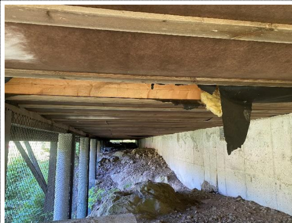
Bilde nr. 2.12 Bygg 8. Noe buling på trefiberplatene mellom lektene.
