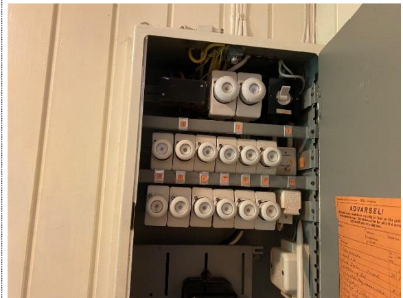
Bilde nr. 4.01 Skrusikringer i en leilighet i bygg 9.
