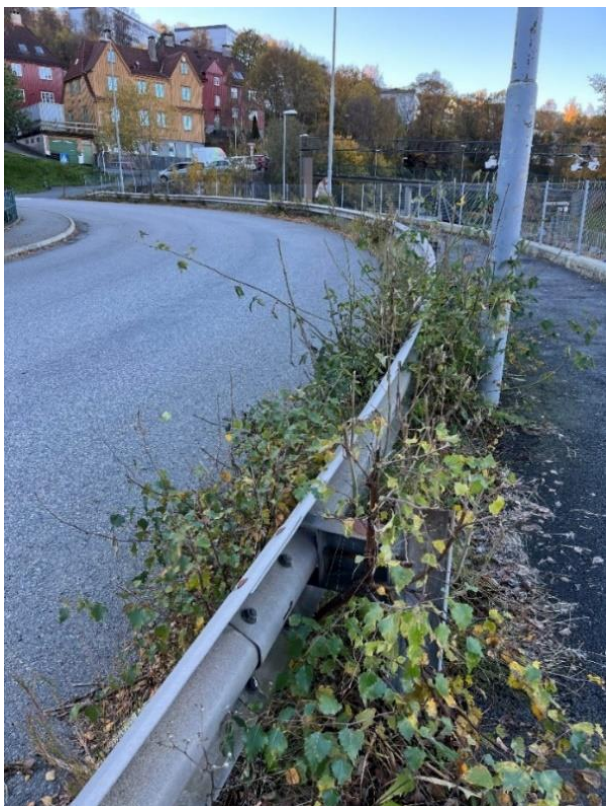
Figur 3: viser hvordan trær og annen kantvegetasjon holdes nede langs autoværn. Bjørken som vises fremst i bildet er i dårlig stand etter å ha blitt utsatt for kvisting/rydding. Foto: Norconsult, oktober 2023.
