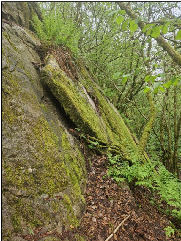
Foto 13. Bergskrent med potensiale for utløsning av bergflak. Bildet tatt mot sør.
