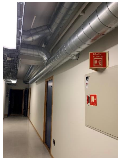
Bilde 10 Ventilasjonskanaler i kjelleretasje
