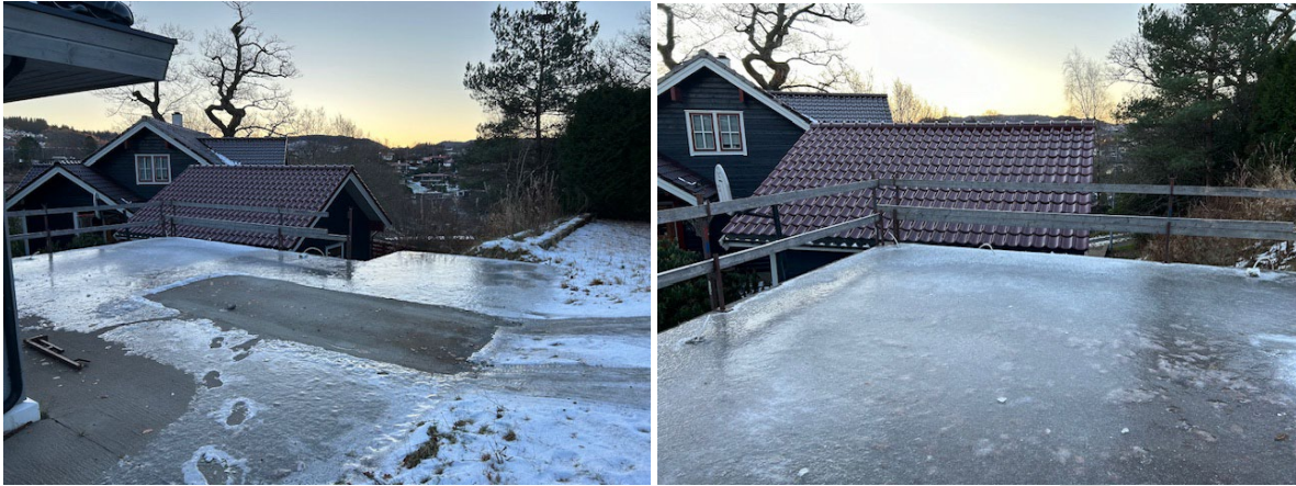
Figur 4-1: Bilder som viser takflaten til boden sammenkoblet med forslagsstillers utearealer, samt sikt mot bnr. 274.
