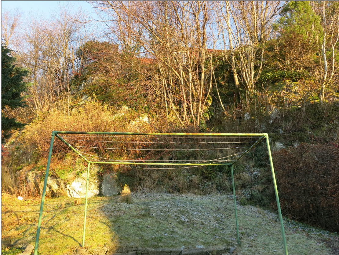
Bilde 3. Den naturlige skråningen i sørlige deler av planområdet, sett mot øst. Her bør vegetasjonen fjernes for å kunne undersøke behov for permanent sikring.
