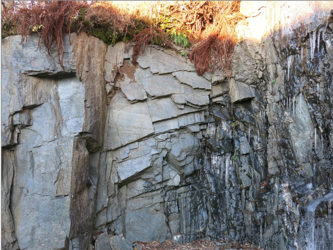
Bilde 1. Nærbilde av forventet bergmasse i fremtidig byggegrøp. Bildet er tatt mot nord ved den eksisterende skjæringen ved Hjortevegen 14.
