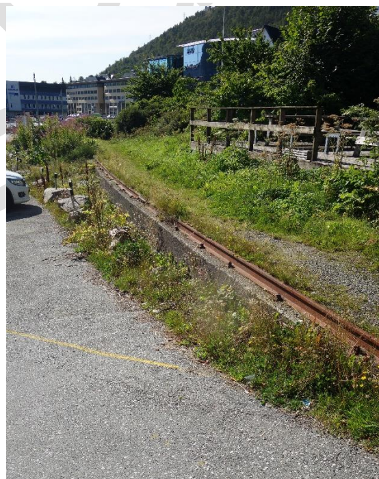
Figur 3-8. Det er synlige jernbanespor i området i dag. Dette sporet ligger høyt i terrenget, og har svak fundamentering uten sviller. Trolig er det et industrispør fra etterkrigstiden som ble brukt for å knytte Mjølnær til Vossebanens nye trasé i tunell under Fløen.
