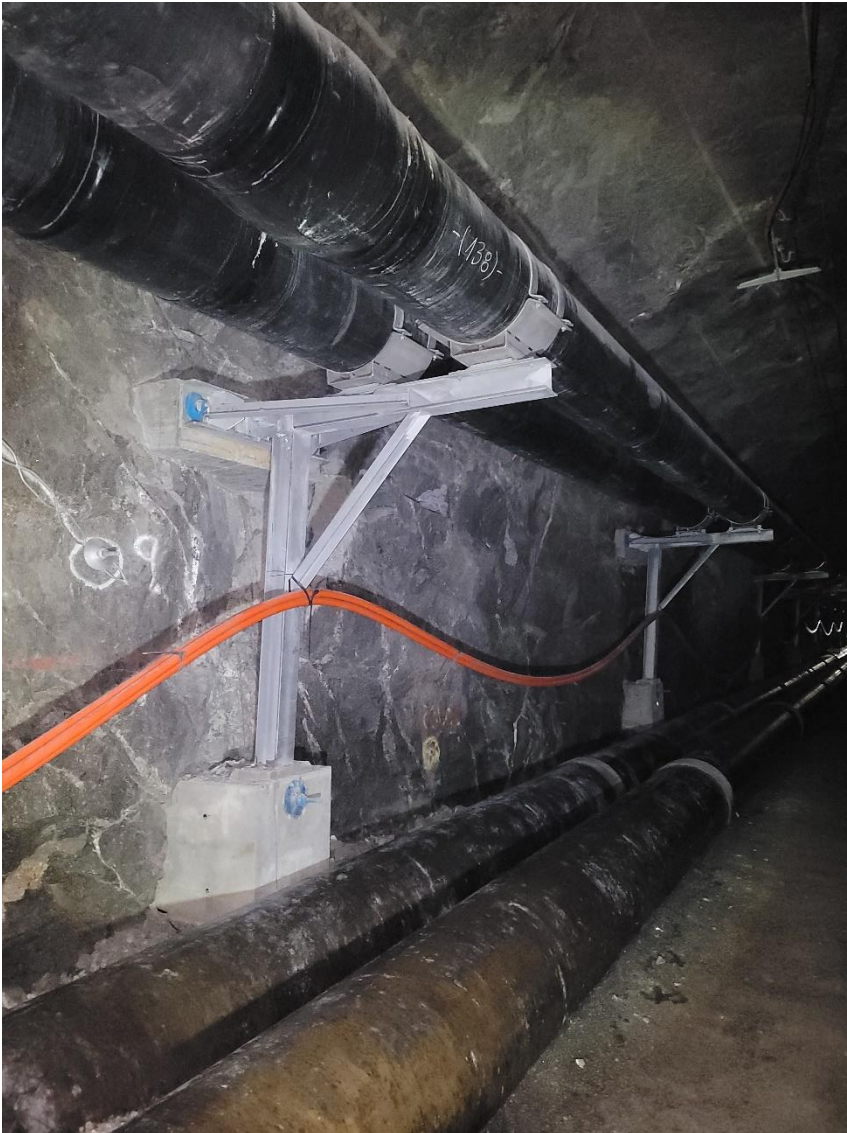
Figur 3 Oppheng fjernvarme nord for nisjen og vannledninger/avløpsledninger langs sålen
