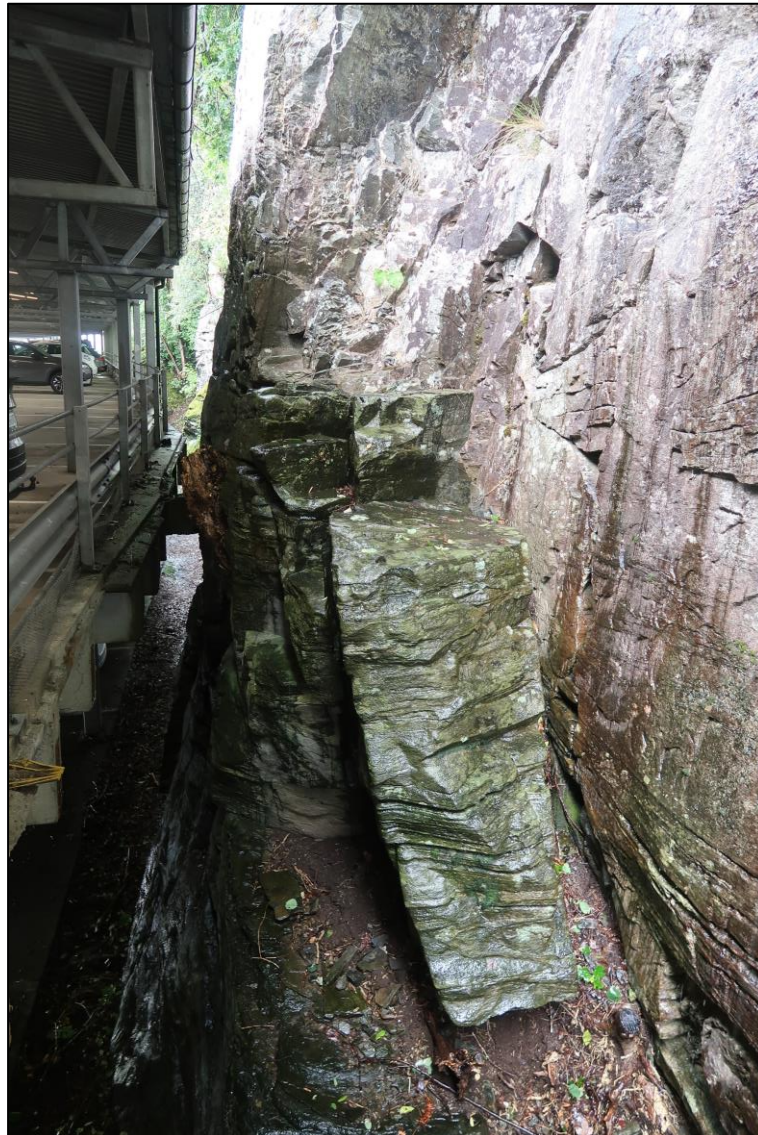
Figur 6. Oppsprekkingen i berget resulterer i avløste blokker i skjæringen mellom planområdet og parkeringshuset nedenfor. Grunnet skadepotensialet på parkeringshuset kreves omfattende sikring av skjæringen før igangsetting av sprengningsarbeider.
