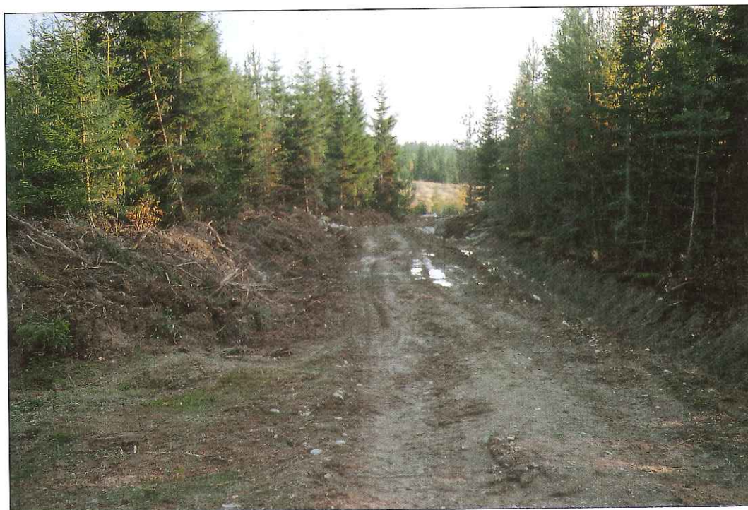
Bilde 28 og 29 Hvis det er nødvendig å bygge grøft, skal grøftemassene ikke plasseres langs veitraséen. De skal transporteres bort til områder hvor de kan planeres ut og eventuelt tilsåes.
