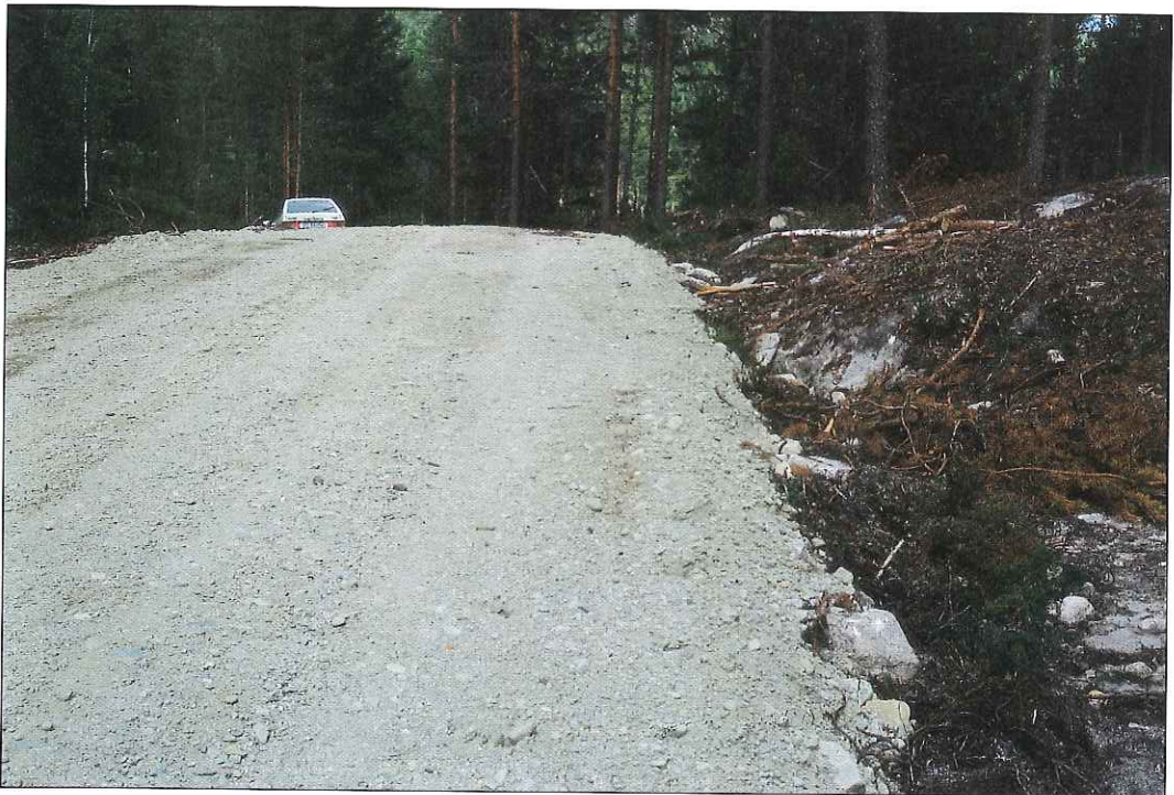
Bilde 27 Der underlaget består av f.eks. morenemasser og på strekninger med høybrekk er grøft ofte overflødig.
