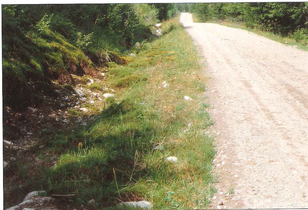
Bilde 26 Veigrøft som har stabilisert seg bør ikke røres hvis vannet dreneres tilfredsstillende.
