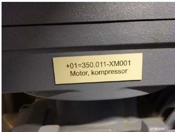
Eksempel på merking av en motor for kompressor. XM er komponentkode for elektromotor.
