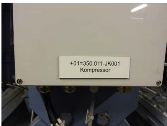
Kompressor er merket med komponentkode JK og løpenummeret er 001. Kompressor er en del av systemet 350.011.
