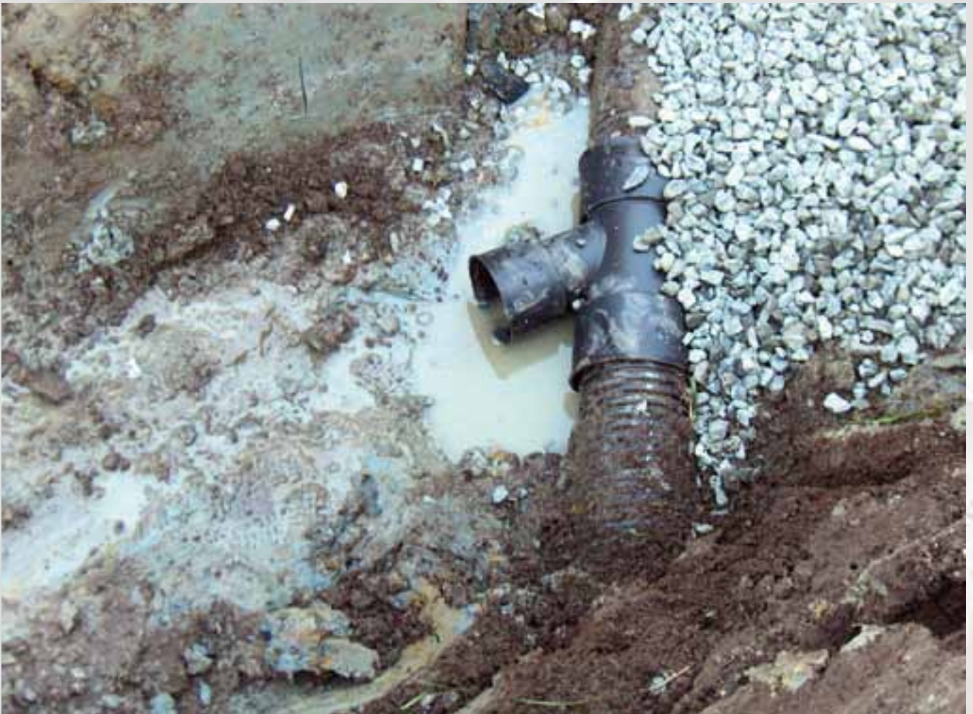
Singel er godt eigna filter der ny og gamal grøft møtest. Frå høgre kant kjem det inn ei gammal steingrøft som er kopla til. Singelen kunne med noko fordel vore noko finare (2-8 mm). Foto: Leif Trygve Berge.
