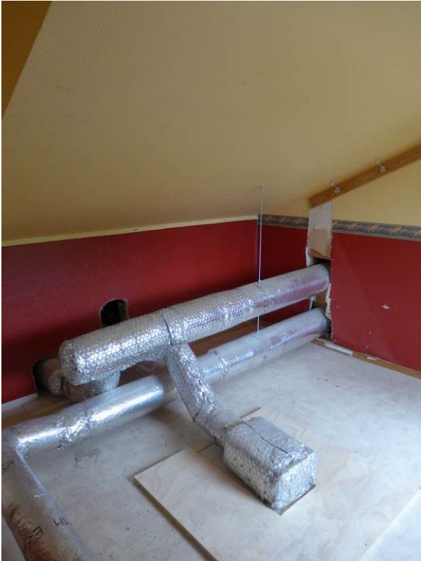
Figur 19: I forbindelse med installasjon av lufteanlegg er stor deler av loftsetasjen benyttet til rør o.l. (Kilde: Bergen kommune, Byantikvaren 2015).
