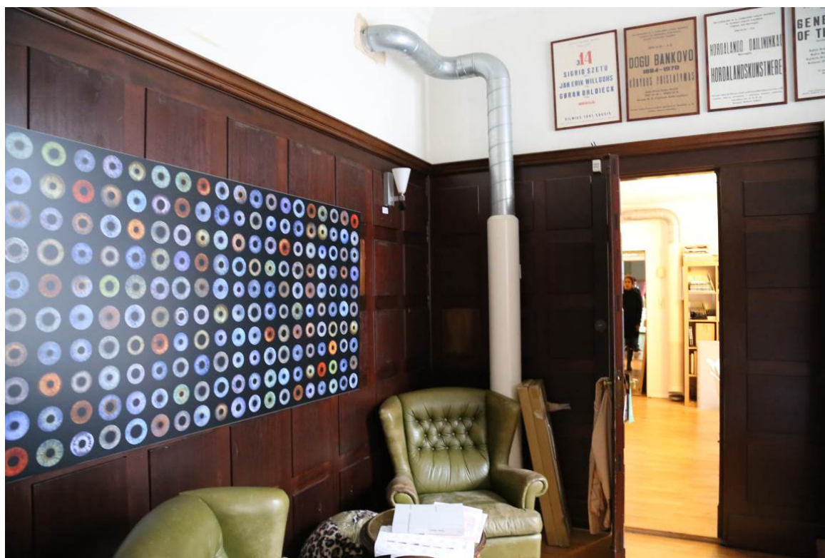
Fig 11. Parti fra styrerommet med edeltrepaneler på alle vegger. Fra Schak Bulls ombygging 1925-27. En vært uheldig og skjæmmende løsning for ventilasjonsanlegg (Foto: Byantikvaren 2015).
