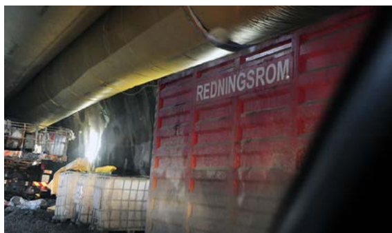
HMS: Slik ser redningskamrene ut, i fall det skulle oppstå brann.
