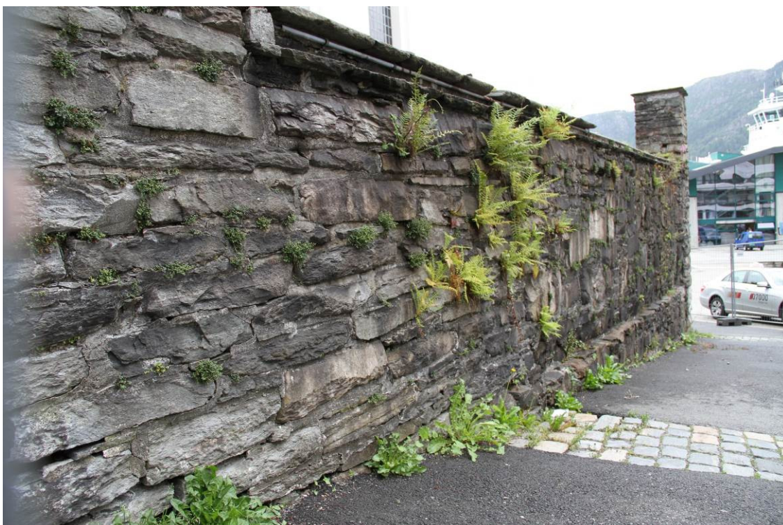
Fig. 17. Før tiltaket. Murlivet mot sør var preget av begroing, løs stein og sprukne murfuger. Foto mot øst (foto: Byantikvaren 2009).
