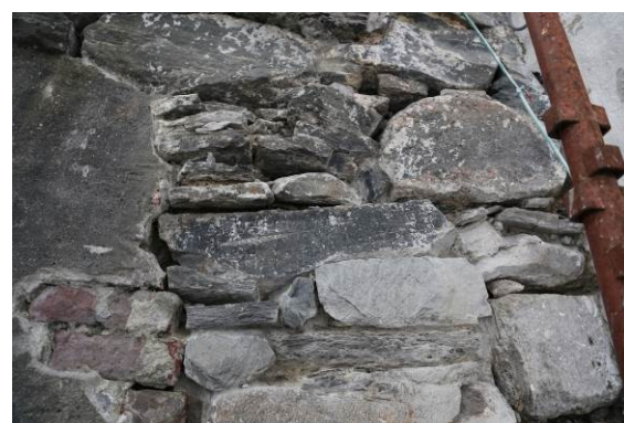
Fig. 29. Detaljfoto av utkrassede fuger i østmuren (foto: Byantikvaren 2103).
