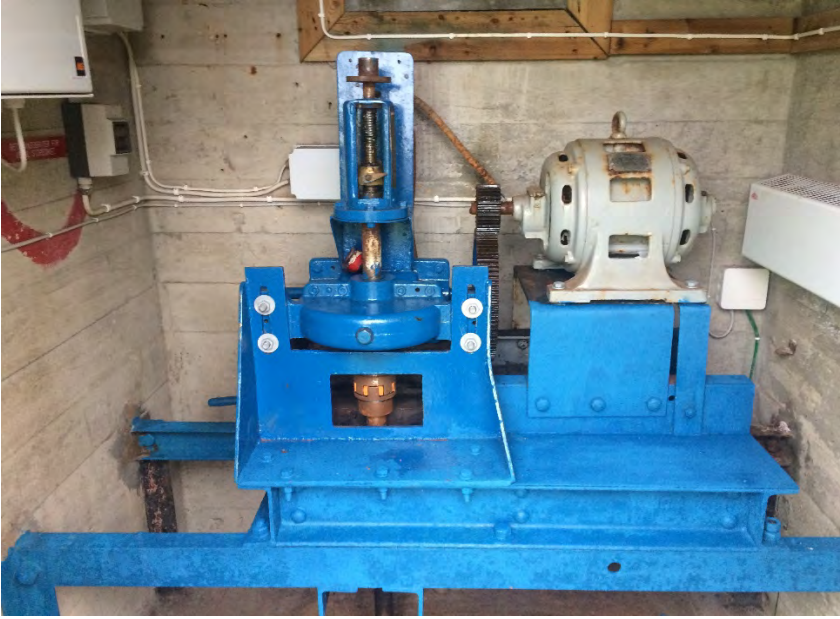
Figur 52: Det elektrisk drevne fjernstyringsanlegget i damhuset på Storediket skulle på en rasjonell måte sikre at vannmengdene i magasinet kunne tilføres i kontrollerte mengder til inntaksdammen i Skredderdalen. Elektromotoren er levert fra «Den norske dynamofabrik i Kristiania. Damluken kunne på denne unike måten styres fra et kontrollpanel i reduksjonskammeret like ved Fjellveien. Foto: Byantikvaren
