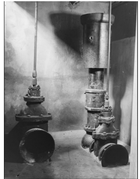
Figur 47: Interiørbilde som viser to ventiler i reduksjonsbassenget.
