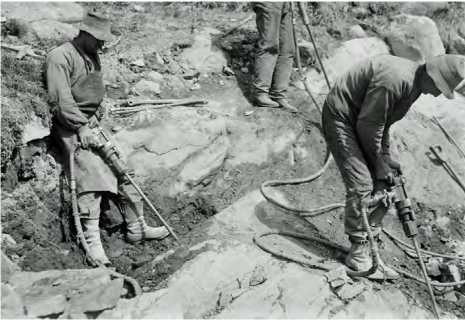
Figur 54: På anlegget i Skredderdalen ble trykkluftsbør benyttet, og arbeidet foregikk i all hovedsak på akkord. Bildet illustrerer arbeidsforhold og bekledning for den tids «rallarere». I steinbruddet måtte det tas ut over 3000 m 3 stein for å kunne heve inntaksdammen med 5 meter, og dammen ble forøyet med omhyggelig muring etter de samme prinsippene som den gamle dammen, men med et 1,2 m tykt tetningssjikt der det ble fuget med sement. Over 70 % av de totale anleggskostnadene for dammen var knyttet til utført arbeid.
