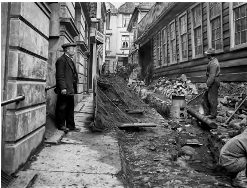
Figur 44: Vannledning under nedleggelse i Veitesmauet, en av byens mange trange gater og smau der denne typen arbeid kunne være krevende. Legg merke til blykokeren som ble benyttet til tetting av skjøtene i støpejernsrørene.
